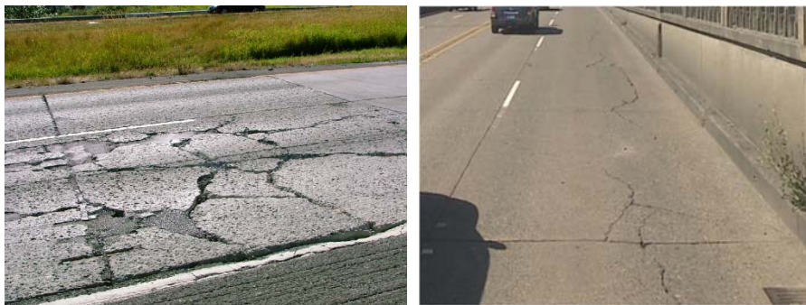
Figura 71 – Distrugerea totală a dalelor
