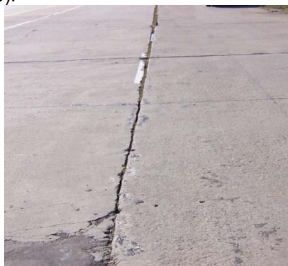
Рисунок 50 - Раскрытие продольных швов
