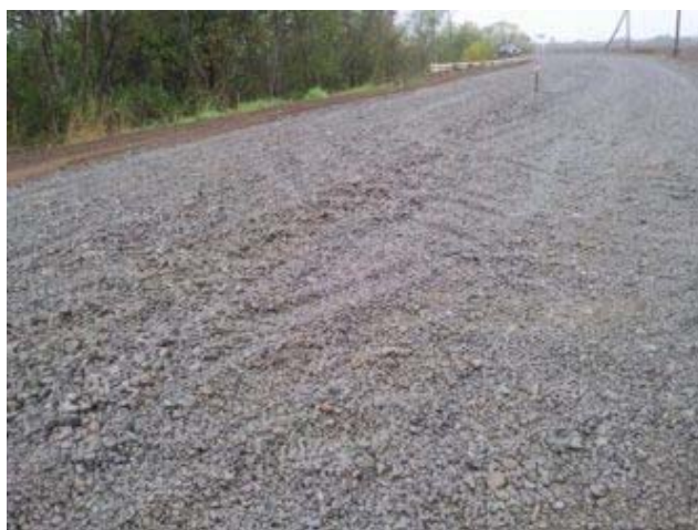
Рисунок 79 – Деформация поперечного профиля дороги
