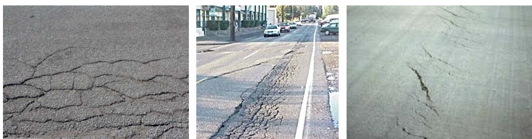
Figura 32 - Fisuri și crăpături unidirecționale multiple
