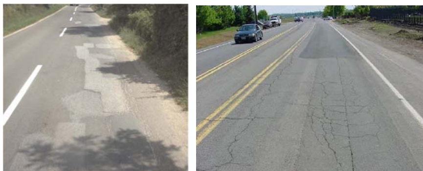
Figura 24 - Plombări cu nivel de severitate mediu
