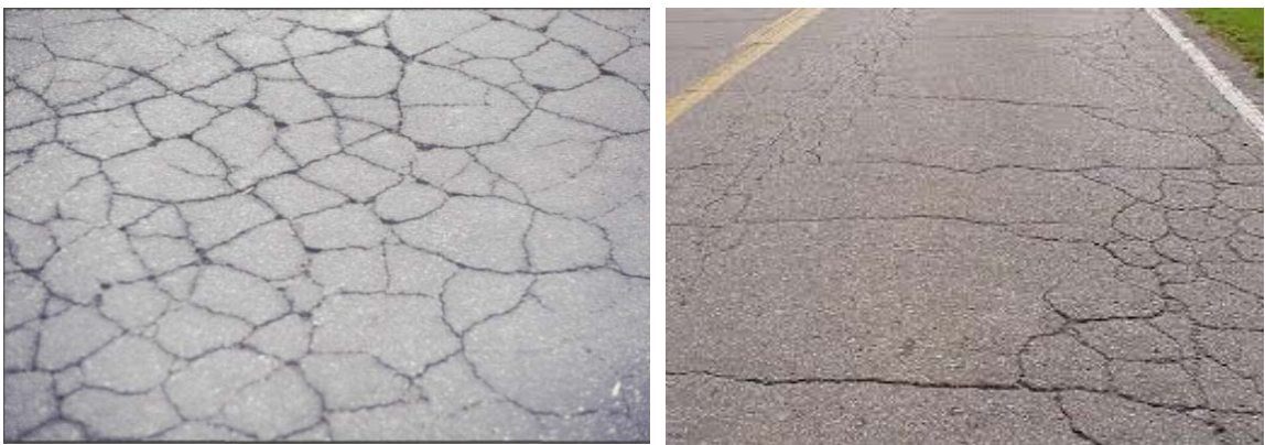
Рисунок 33 - Сетка трещин в виде кожи крокодила
