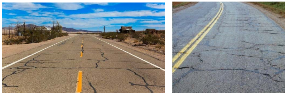
Figura 31 - Fisuri și crăpături multiple pe direcții diferite
