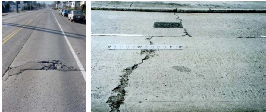
Рисунок 52 - Сколы кромок плит в зоне швов
