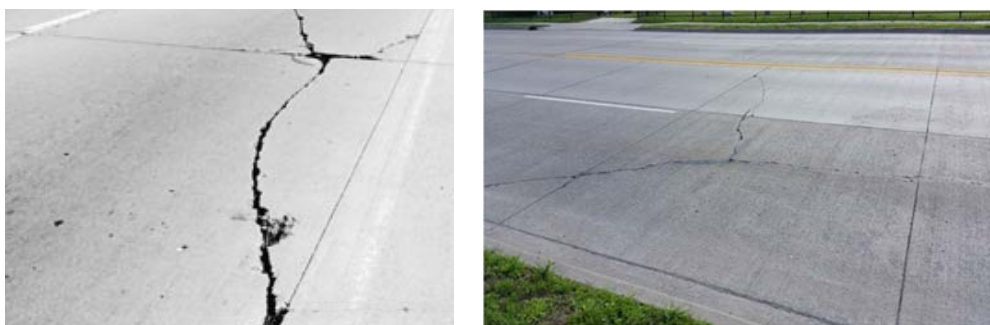
Figura 60 – Fisuri și crăpături diagonale
