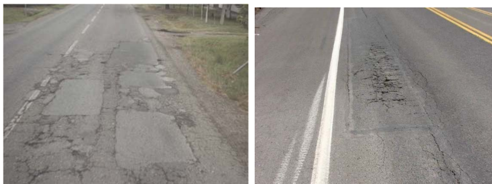
Figura 25 - Plombări cu nivel de severitate ridicat
