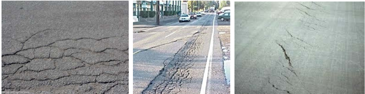
Рисунок 32 - Множественные однонаправленные трещины
