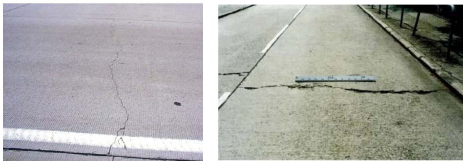
Figura 56 - Fisuri și crăpături transversale
