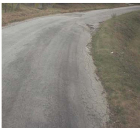
Рисунок 16 – Разрушение (скол) кромок
