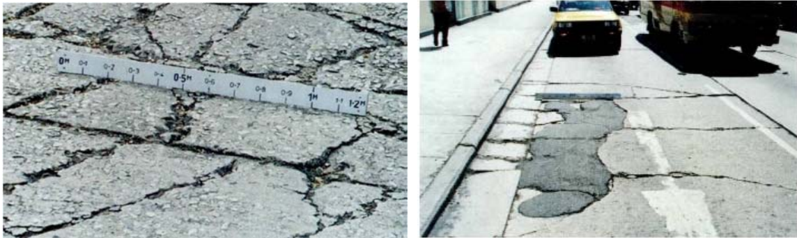
Figura 68 – Fisuri în plăci
