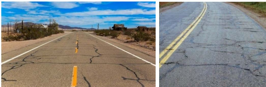
Рисунок 31 - Множественные трещины в разных направлениях
