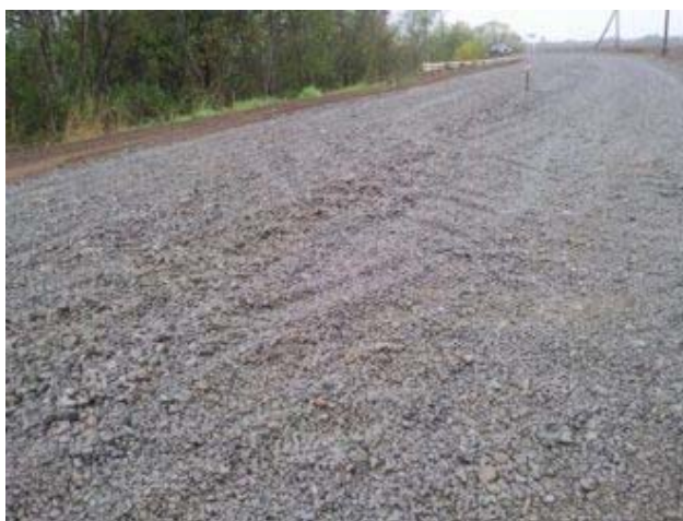
Figura 79 – Deformarea profilului transversal al drumului
