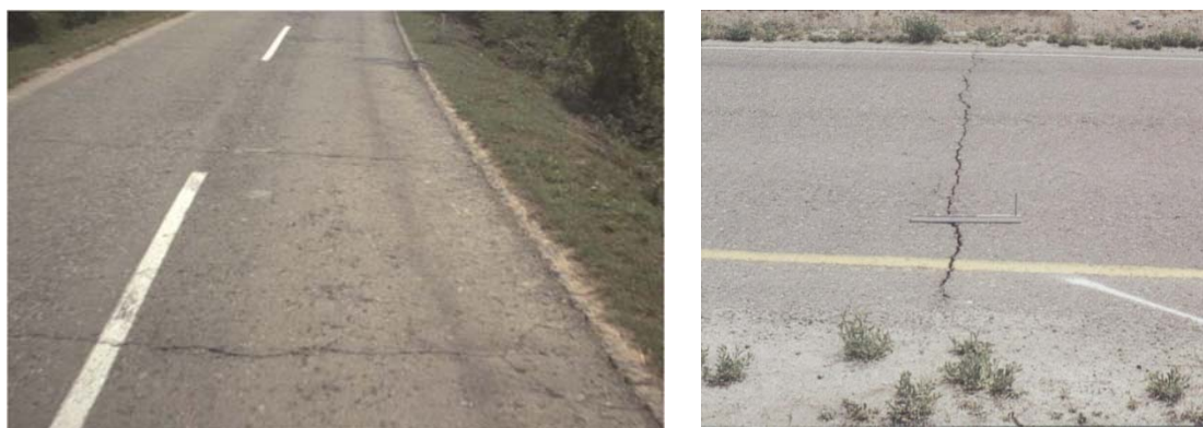
Figura 27 - Fisuri și crăpături transversale
