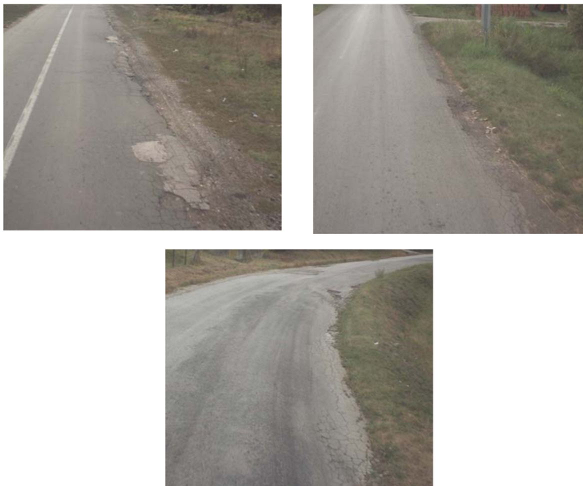
Figura 16 - Rupturi de margine
