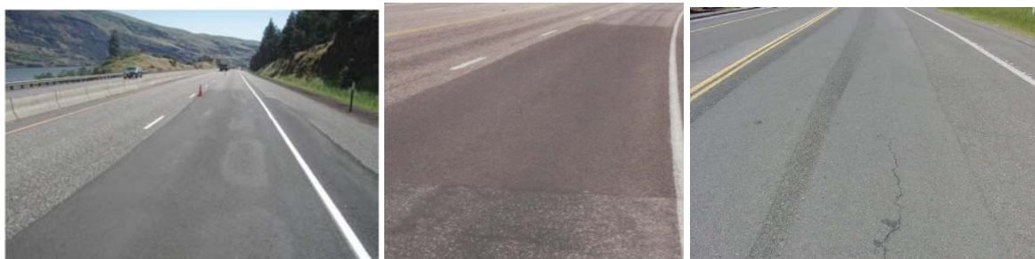
Figura 23 - Plombări cu nivel de severitate scăzut
