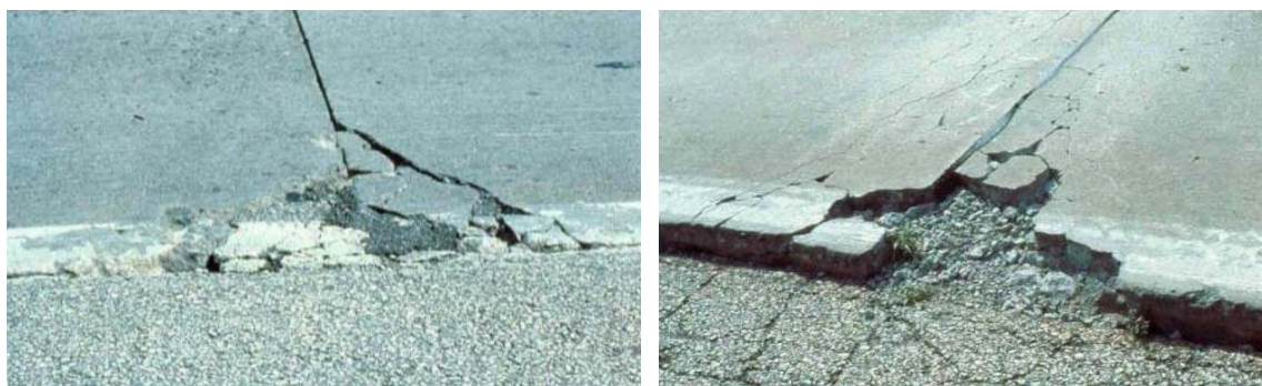
Рисунок 54– Сколы углов плит
