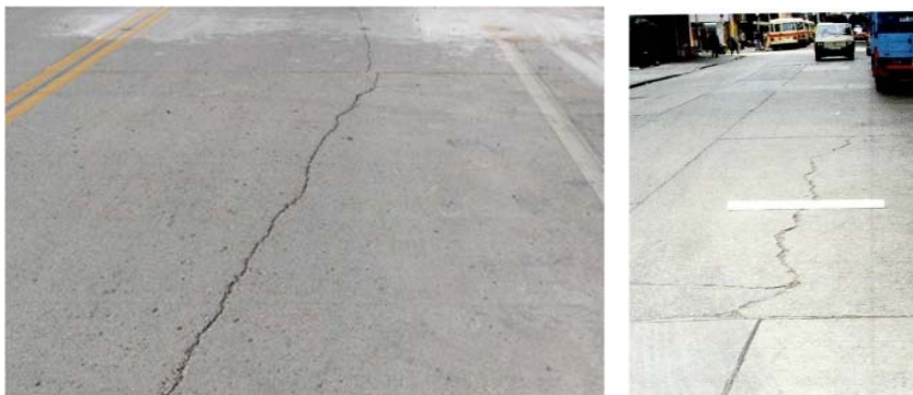
Figura 58 – Fisuri și crăpături longitudinale
