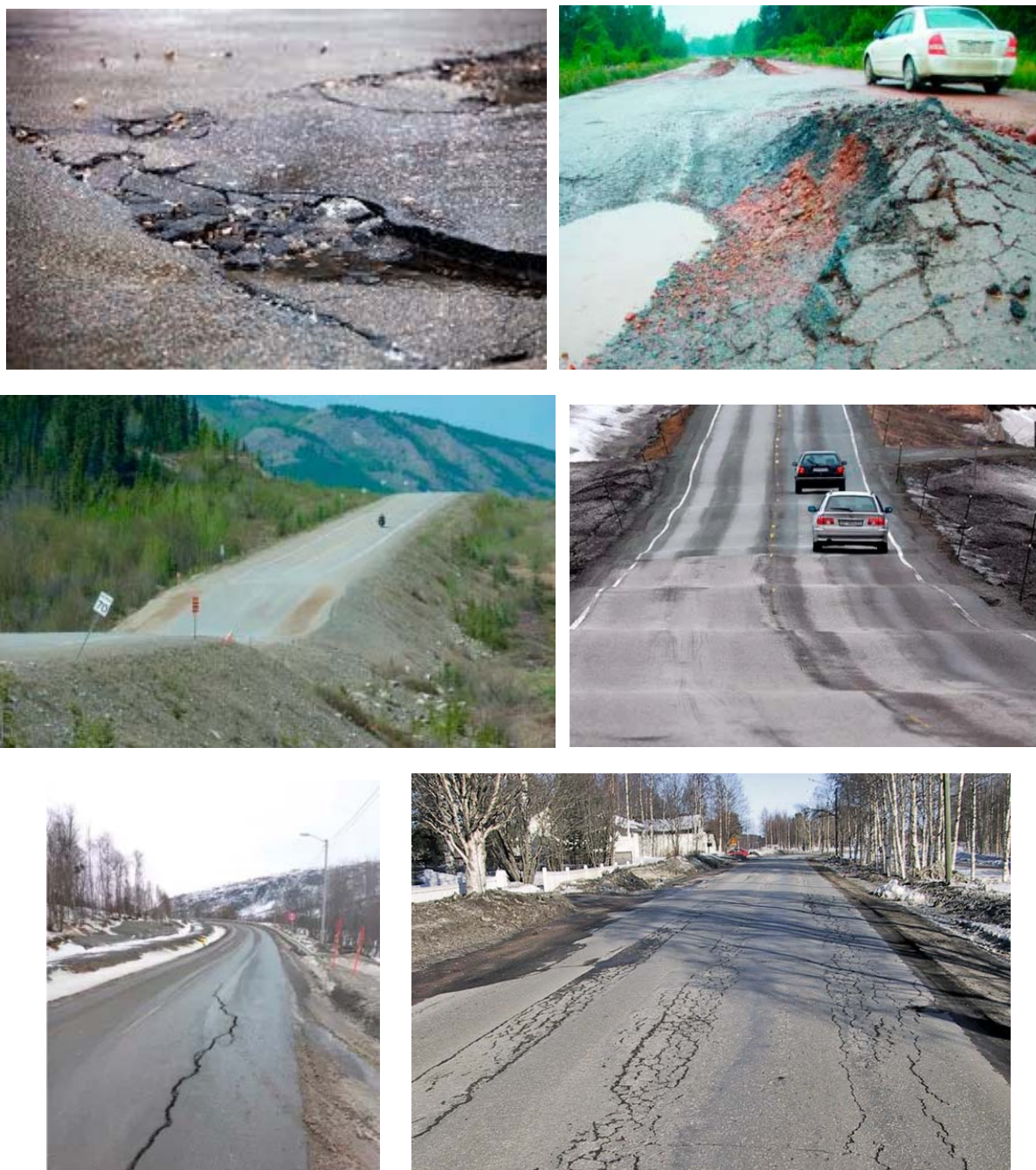
Figura 36 – Degradări provocate de îngheț-dezghet
