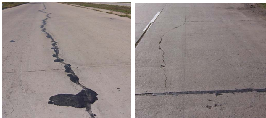
Figura 51 - Rosturi cu mastic în exces
